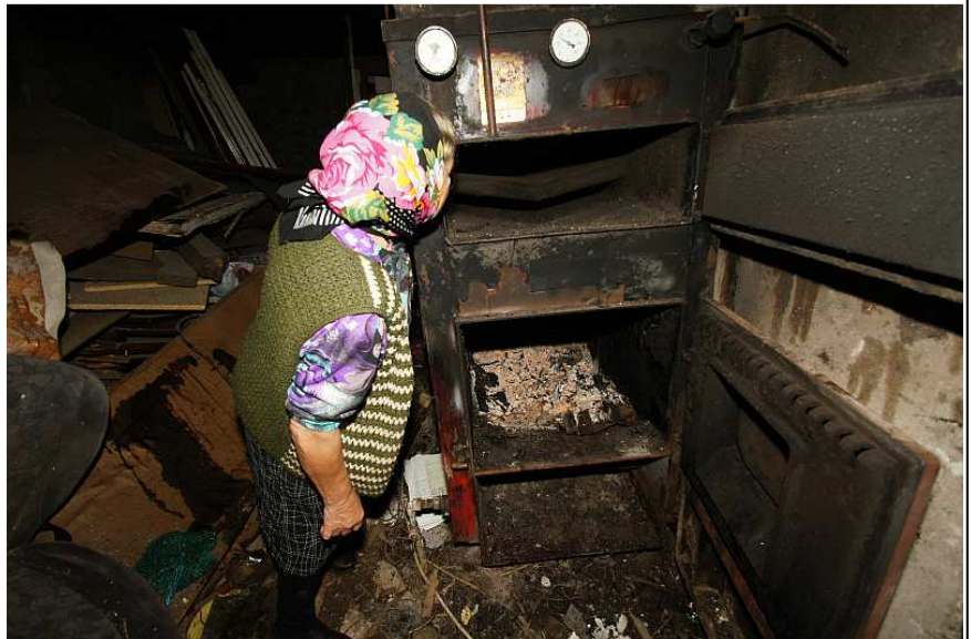
Mevrouw Radulescu laat de doorgezakte buizen in de warmtewisselaar zien. Total loss.
