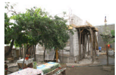
Een foto die gemaakt werd deze zomer. Inmiddels is de tweede etage en het dak erop. Nu de verwarming en de afbouw nog. Het is niet groot maar het zal wel een grote verbetering zijn!
