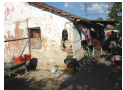
Duidelijk is dat het huisje in slechte staat verkeert.
